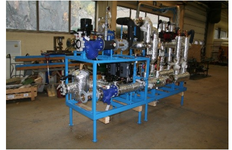
Tekniske sentraler til varme- og kjøle-behov.
